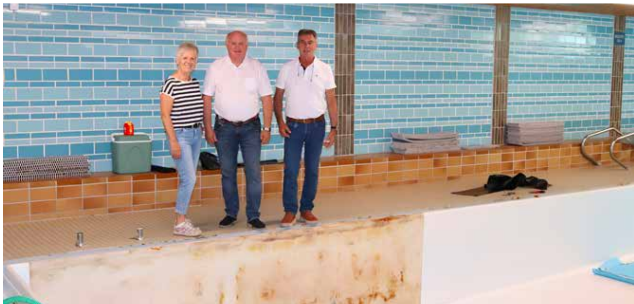
Familiengemeinderätin Ingrid Wendl, BGM Ernst Wendl und GGR Herbert Stuxer begutachten das sanierungsbedürftige Lehrschwimmbecken in der Volksschule
