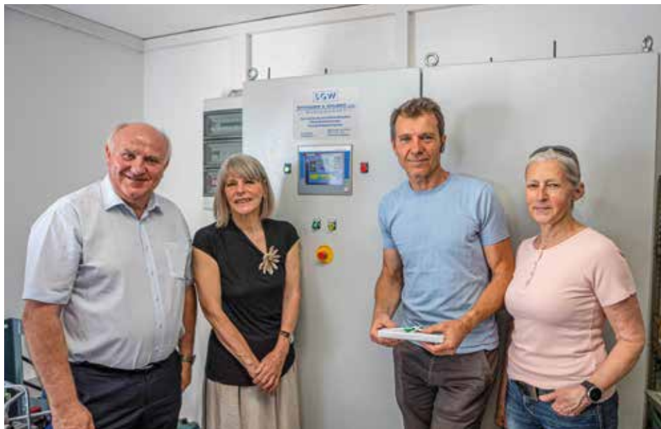
BGM Ernst Wendl, Kaplan-Enkelin Dr. Gerlinde Weber, Günter Menzl und Marion Kaiser bei dem Steuerschrank der neuen Kleinwasserkraftanlage bei der Inbetriebnahme
