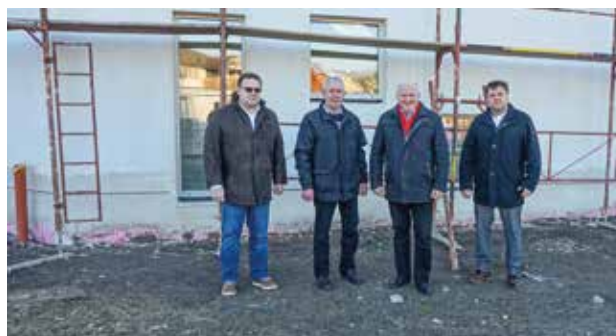
GR Ernst Mrazek, GR Gerhard Amstadt, BGM Ernst Wendl und GGR Manfred Mitzl überzeugen sich vom Baufortschritt des Kindergartenzubaus
